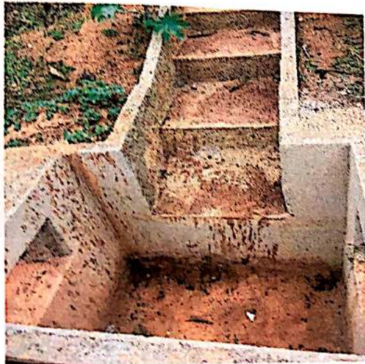
Figura 12 – Caixa de Passagem do sistema de drenagem do Aterro de Grama. Fonte: Autoria Própria
